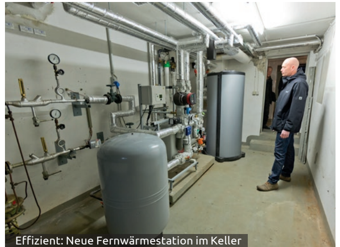
Effizient: Neue Fernwärmestation im Keller
